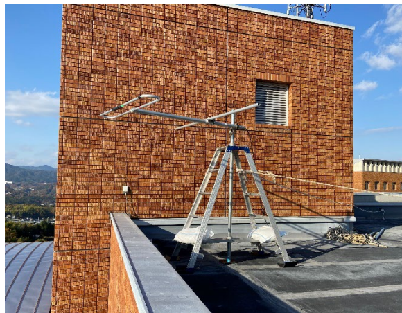
(アンテナ設置状況)
