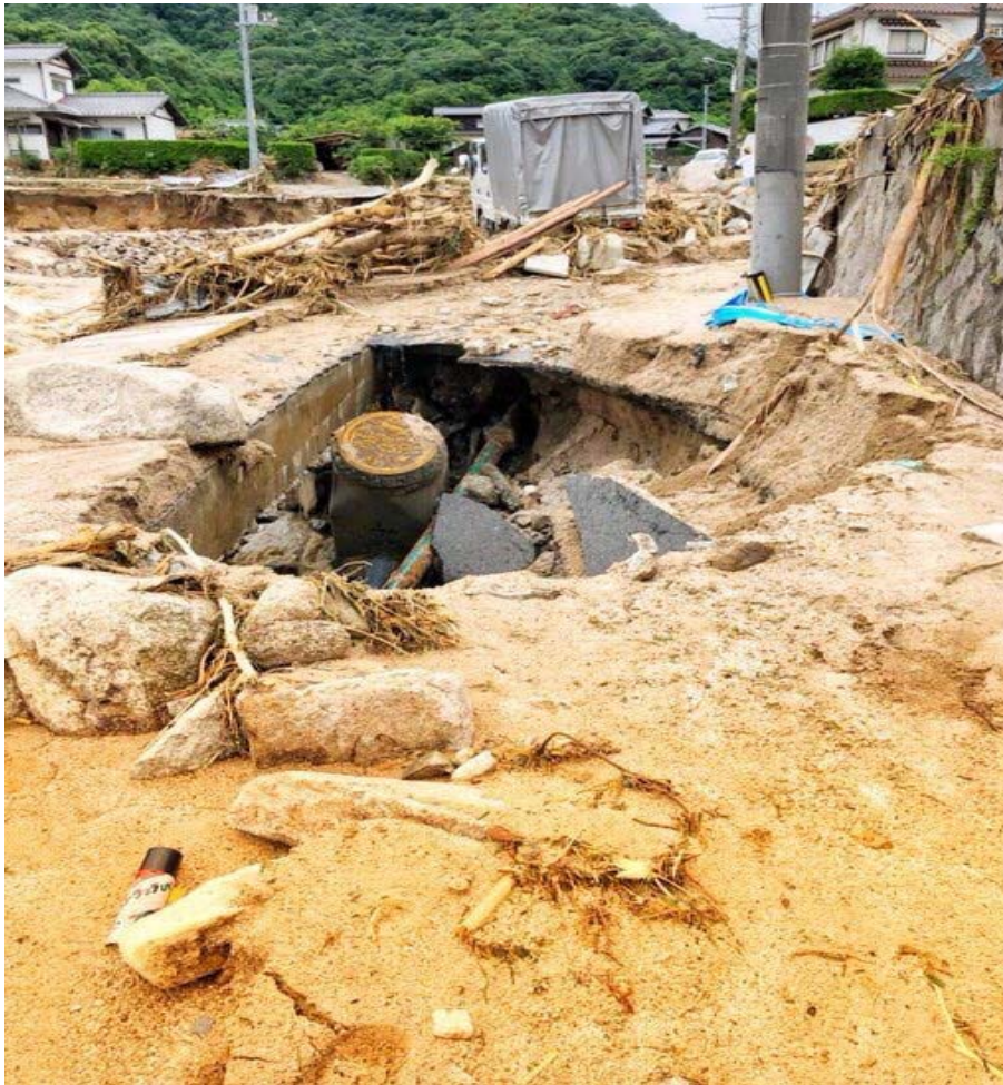
▲土石流によって陥没した道路 (総頭川上流域)
