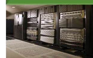
携帯基地局・システム
