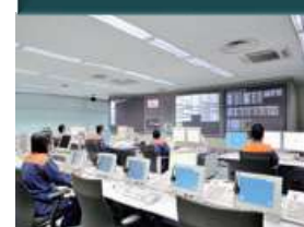
消防・防災システム
